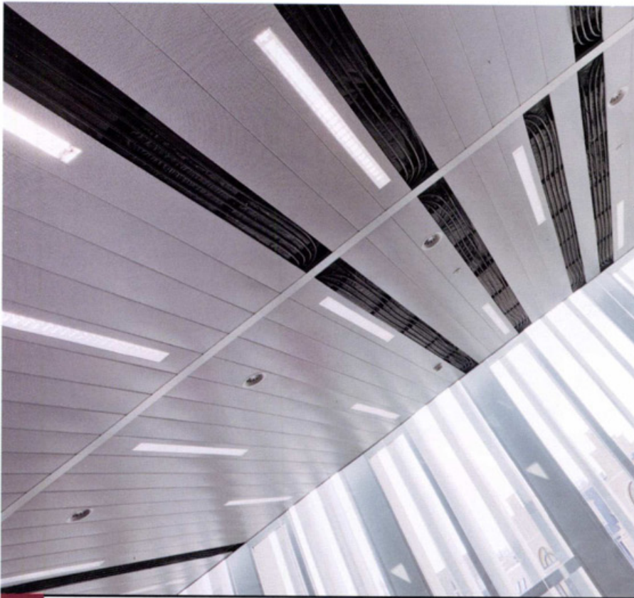
Een zicht op de koel-, isolatie en akoestiektechnieken in de klimaatplafonds.
